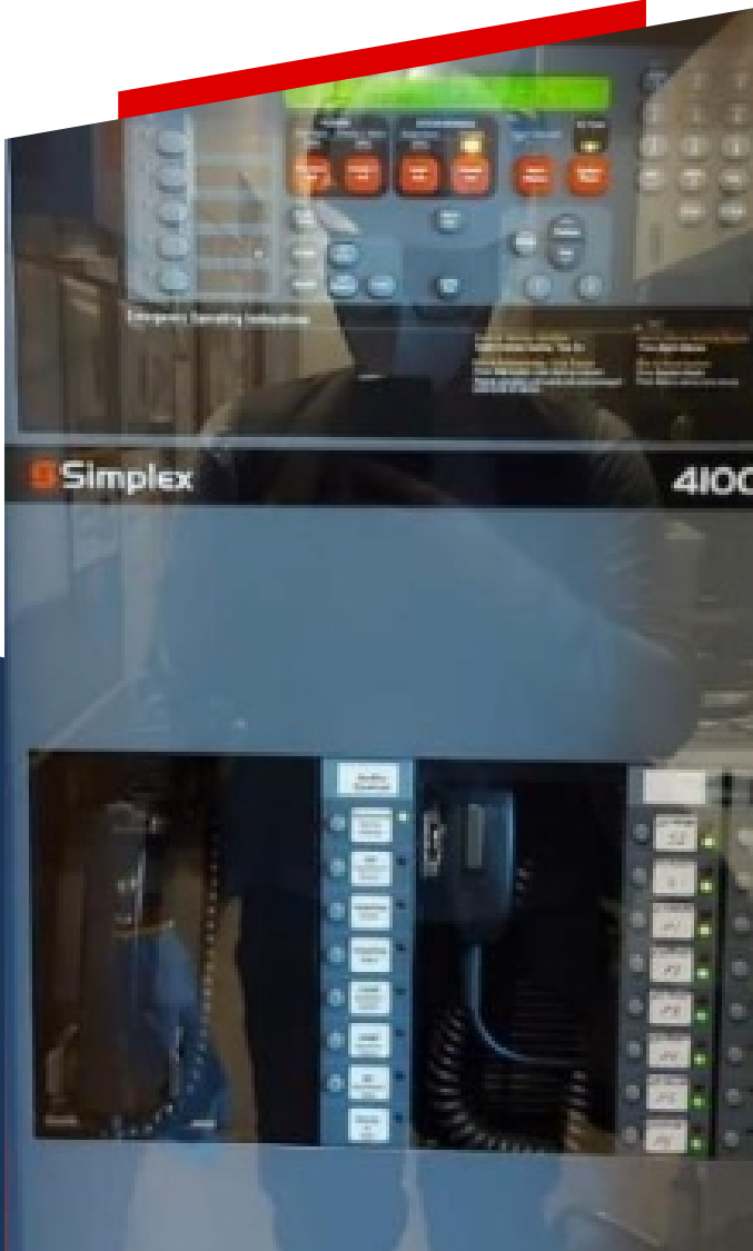
DETECCION Y ALARMA CONTRA INCENDIO
