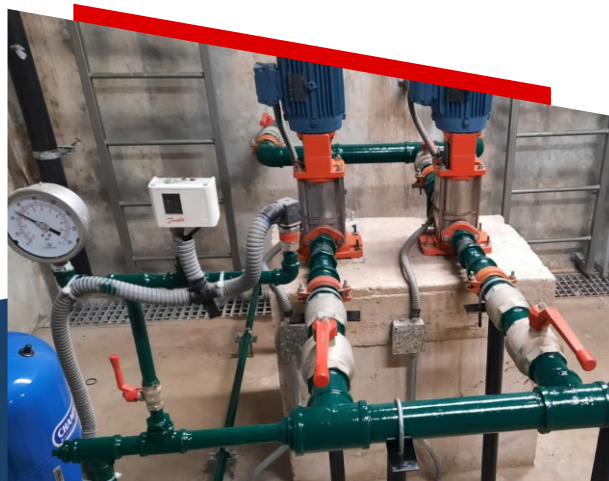
BOMBAS CONTRA INCENDIO
