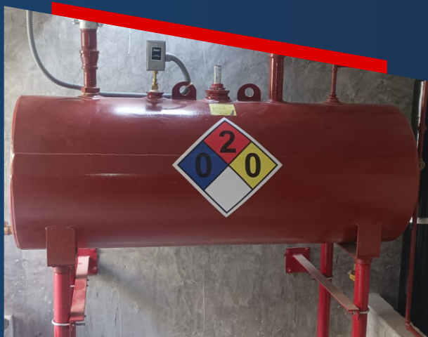
BOMBAS CONTRA INCENDIO
