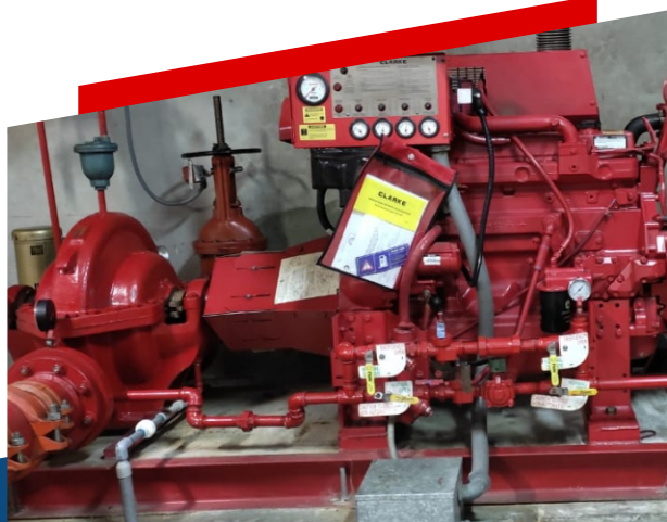
BOMBAS CONTRA INCENDIO
